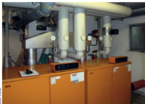
Die vorhandene Doppel-Kesselanlage in der Wohnanlage
