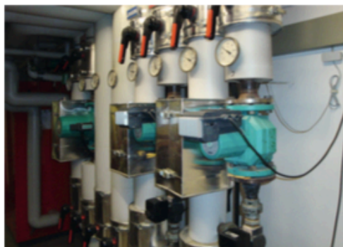
Verteiler mit zwei Heizkreisen für Heizungs-Temperaturspannung 80/60 °C
