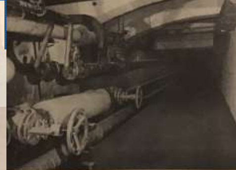
Anordnung von Rohrleitungen im Leitungsgang auf der Straßenseite Foto: Kämpfer, Leipzig
