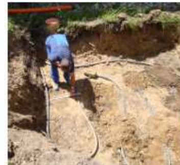
Bild 12: Verlegungen des Kollektors 2010 konnte die Verlegung, nahezu nach den Maßen des Bildes 10 erfolgen
